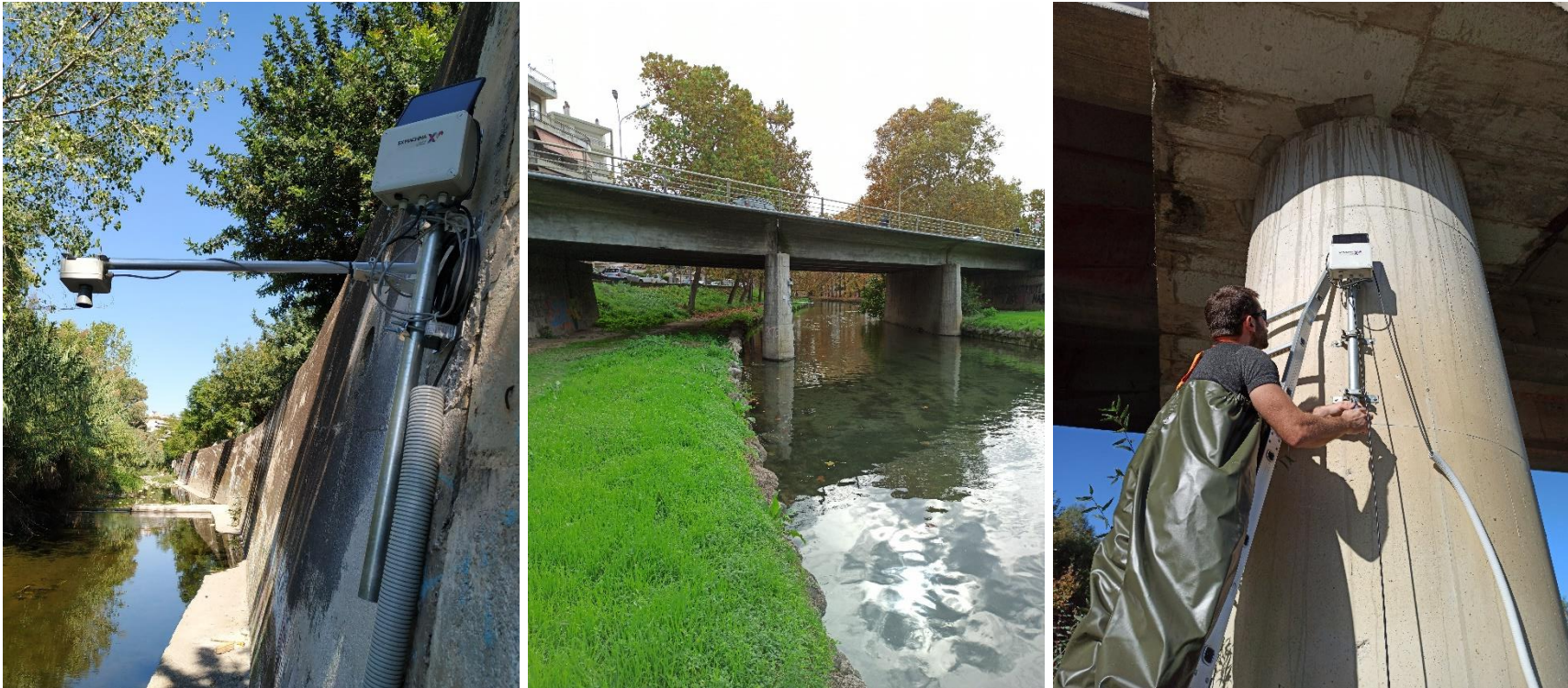
Εικόνα 3. Αριστερά: ο σταθμός Picrodafi στο ρέμα της Πικροδάφνης, στα νότια του πολεοδομικού συγκροτήματος των Αθηνών. Κέντρο: ο σταθμός Lithaios στον ποταμό Ληθαίο, εντός του πολεοδομικού συγκροτήματος των Τρικάλων. Δεξιά: από την εγκατάσταση του σταθμού Spercheios στον ποταμό Σπερχειό, κοντά στα Λουτρά Υπάτης.
